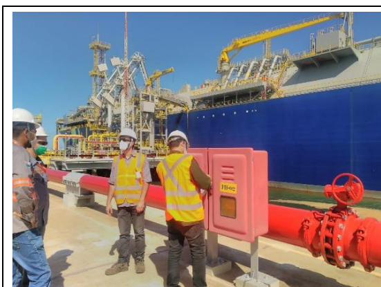
Foto 11: Verificação de componentes de Equipamentos de Atendimento a Emergência no TGNL
